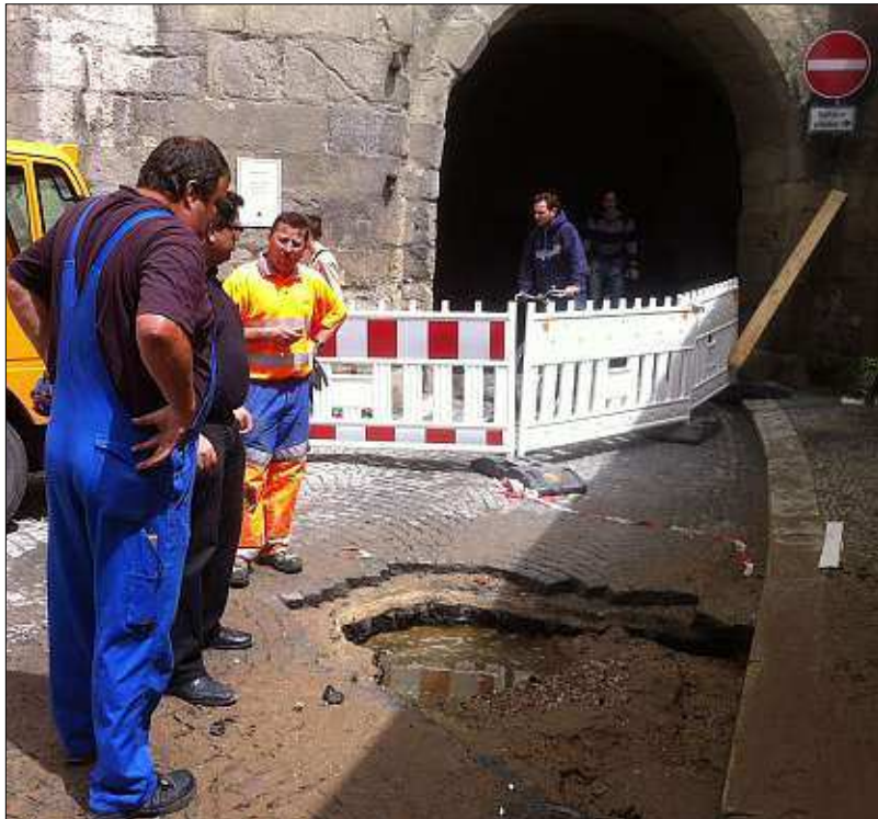
Ein Loch tut sich auf am Ausgang des Innbrückbogens – ein 150-Millimeter-Gussrohr ist gebrochen unmittelbar neben der einsturzgefährdeten und denkmalgeschützten Häuserzeile. Die Innbrückgasse musste gestern zeitweise wieder gesperrt werden. – Foto: Karl
